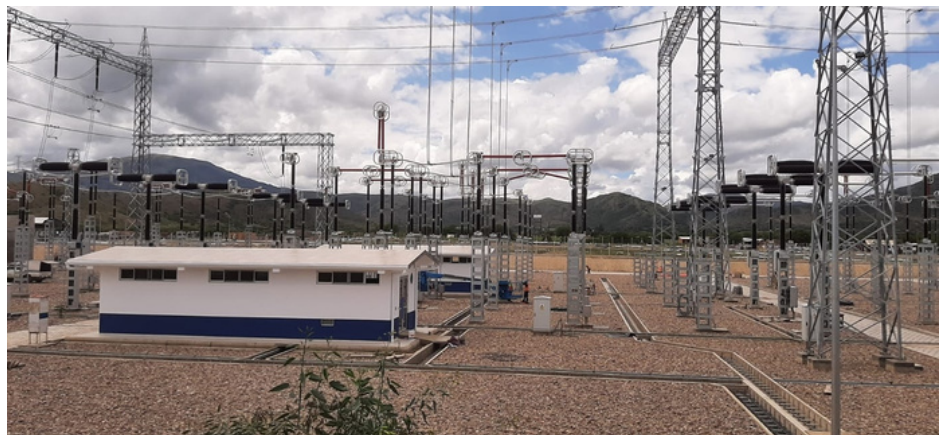
Subestación Santiviáñez 500 kV (Cochabamba)
